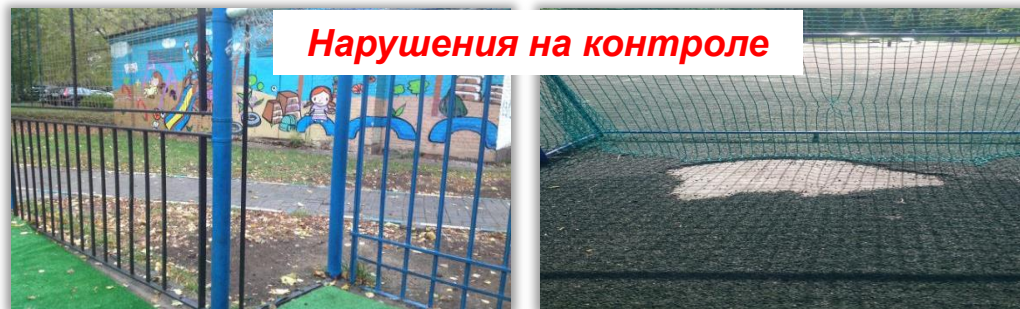
ЮАО , Москворечье ул., 31 к.1 – повреждено ограждение спортивной площадки - ГБУ «Жилищник района Москоречье-Сабурово»
