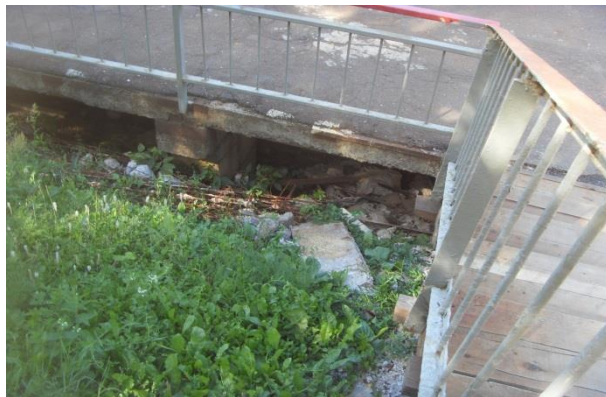
Павелецкое направление, ЮАО, район Царицыно, платформа Чертаново, не убран строительный мусор, Отв. ОАО «ЦППК»
