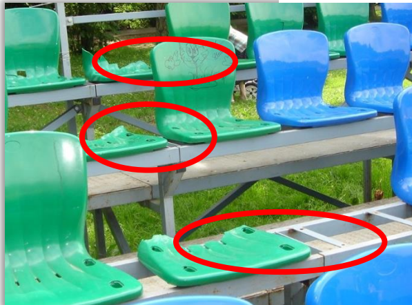
ПИП «Покровское-Стрешнево» Иваньковские пруды №1-7, повреждены (отсутствуют) сиденья на спортивной трибуне - ГПБУ «Мосприрода»
