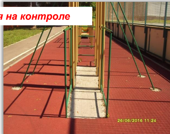
САО, ул. Дегуниная д.18, - не восстановлено покрытие на гимнастической площадке - ГБОУ Школа № 2100
