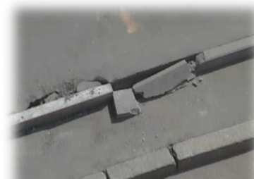
ЦАО, ТПУ «Арбатская» повреждение бортового камня - Отв. орг. ГБУ «Авд ЦАО»
