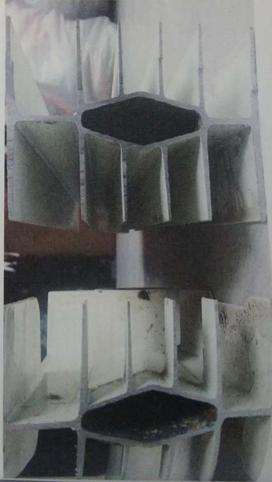
Иллюстрация № 3 Вид дефекта секции радиатора с торца на разрезе
